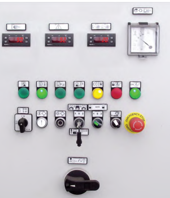
Stationary electrical panel with working devices Електрична панель стаціонарної зерносушарки
